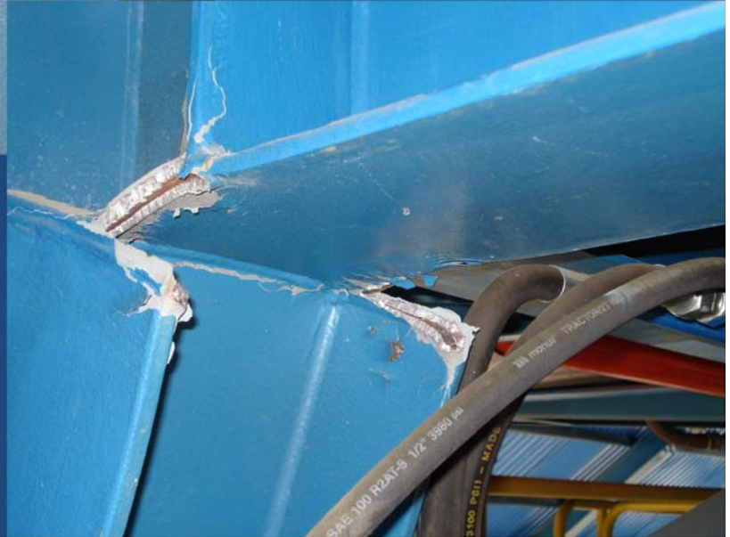
Carro Apilador de Carbón, Central Termo-eléctrica, Zona Coronel; Falla conexión de momento. Detalles
